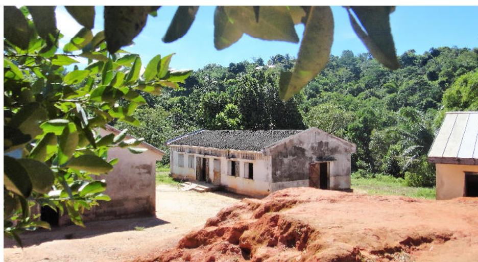
Photo N° 19: Le toit ravagé d'une salle de classe de l'EPP Ambodimanga II
